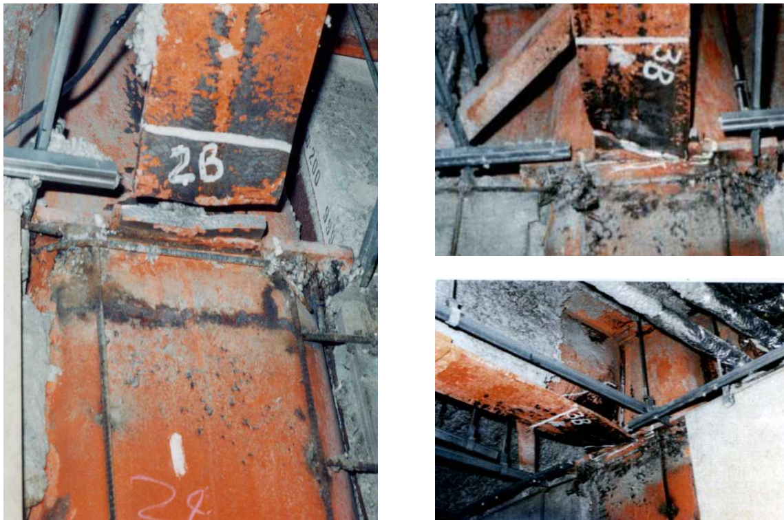
写真1.1 梁端下フランジの脆性破断
