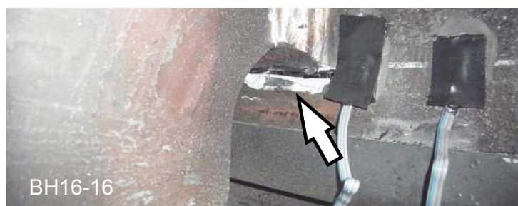
スカルップ底から延性亀裂が進展
